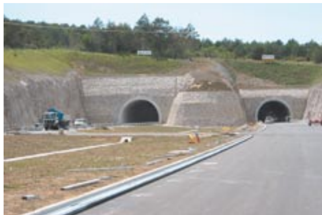
Slika 10: Vzhodni portal predora Kastelec.
