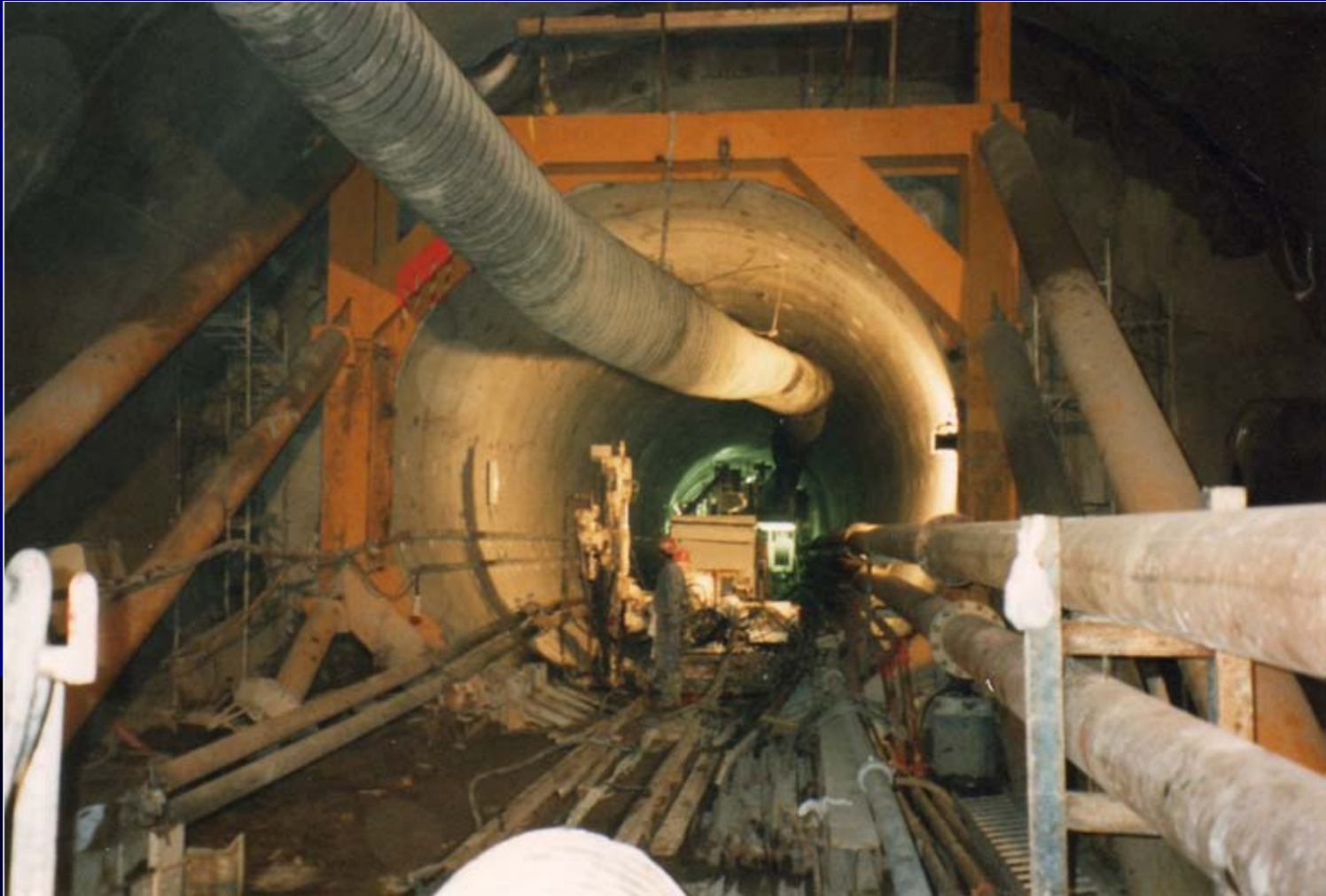
Linije R.E.R. "E" , sekcija 35B u centru Pariza Početna okvirna konstrukcija za potisak stroja na početku sekcije
